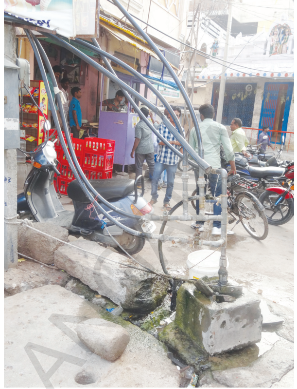
चित्र 14.5: पेयजल की पाइप लाइन (आकाशगंगा)
