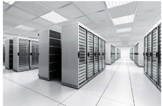
Fig. 4.4 : A data center
